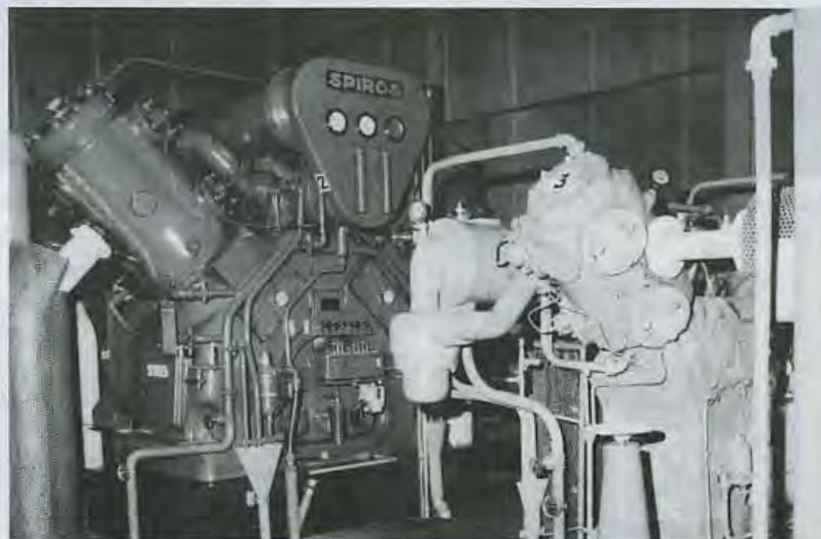
La station de production d'air comprimé.
